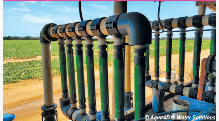
❶ Unités de traitement du système Aqua4D mises en place pour l'irrigation du melon au Brésil.
